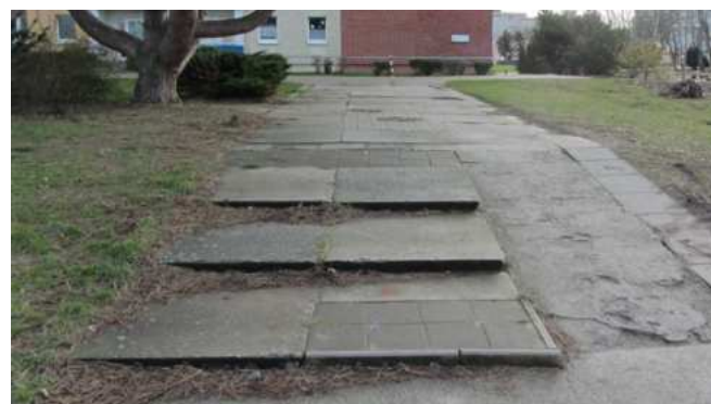
schlechter Zustand des Gehweges vor der Sanierung FOTO SES
