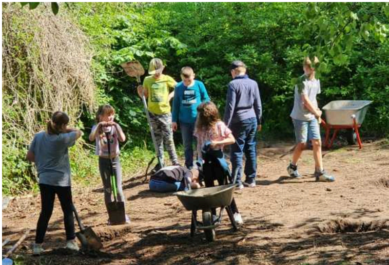
Schulkinder sind fleißig beim vorbereiten von Punktfundamenten für einen Hühnerstall Foto: DS STK
